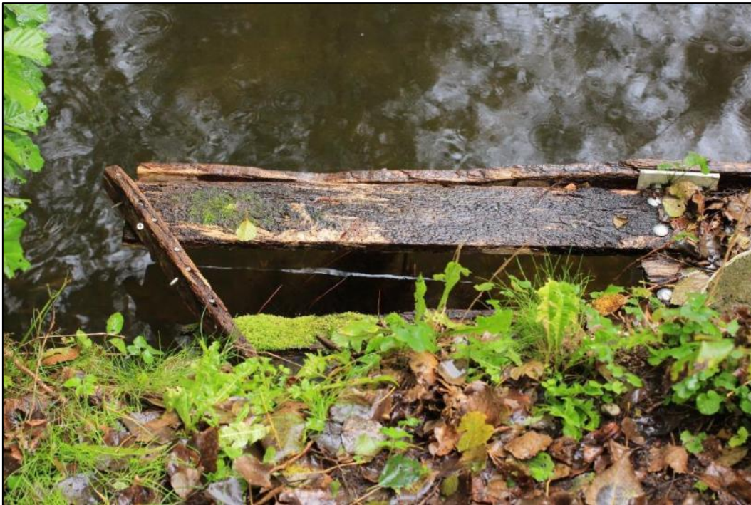
Abbildung 14: Defekte Berme Havelbrücke östlich von Granzin
