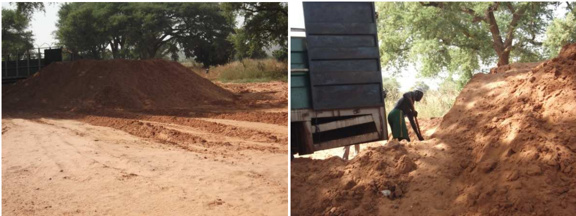
Photo 8 : exploitation d'agrégats dans un ravin en amont du lac
