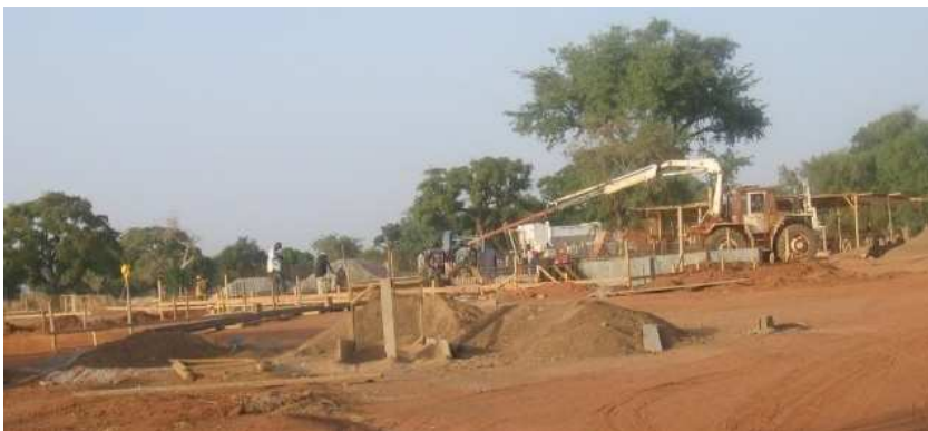
Photo 12: Site de pompage d'eau pour la ville de Kaya, En construction par l'ONEA
