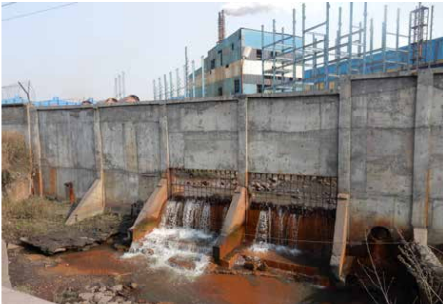
Discharge of industrial effluent
