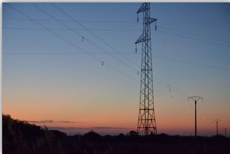
Photo 4 - Lignes électriques sur l'Esquineau - ©D. Cohez / RNRTdV.
