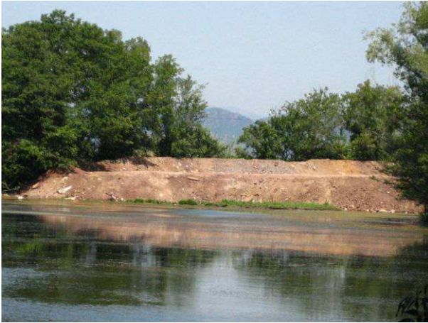
Etang chemin de la sablière en cours de comblement par des déchets inertes (Partie Nord de l'étang situé en bordure d'Argens) - ©Biotope
