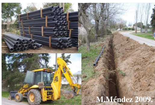
Trabajos de instalación de red de agua potable en el Barrio Las Colinas de Otamendi.
