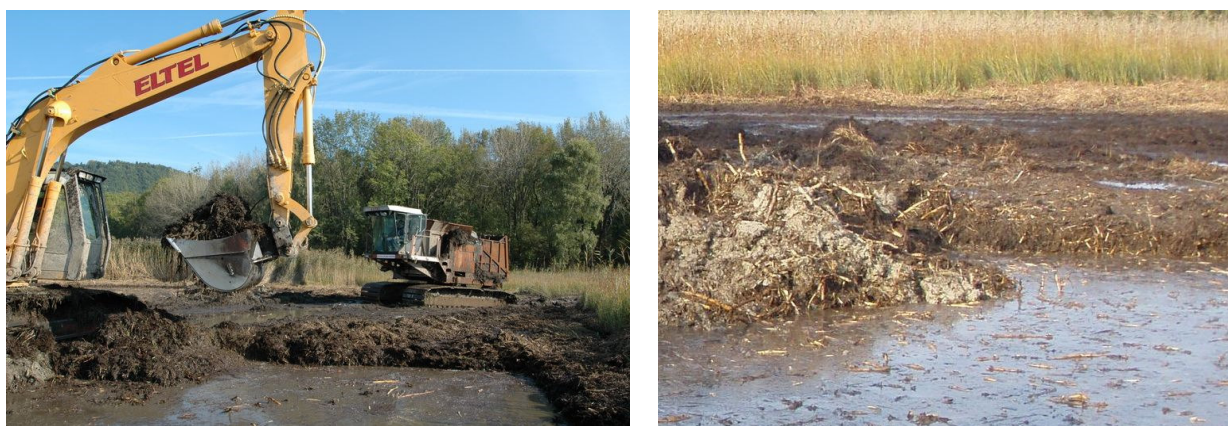
Figure 8.2.9b-c: Décapage de roselière intérieure. A gauche pelle retro chargeant les matériaux organiques dans la benne-convoyeuse de la machine sur chenilles ELBOTEL. A droite, matériel décapé mélangeant matière organique et anmoor
