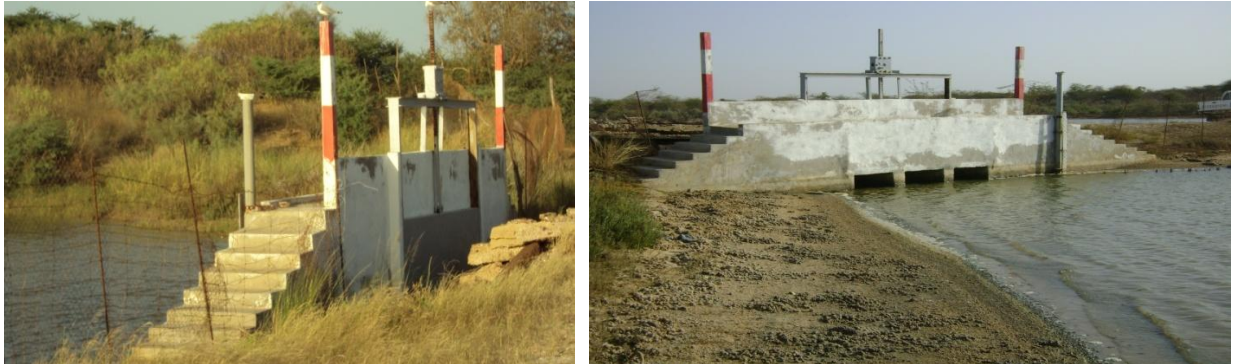
Figure 5 : Ponts de Albar(à gauche) et de Ndiakhère (à droite) avec leurs vannes (Photo, Lt T. Sarr, 2009 et D. Diouck, 2010)
