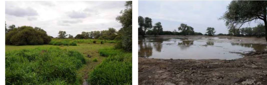
Figure 82. Etang de la Forteresse (n°8), avant et après travaux d'ouverture et de curage (Source : FDC 44)
