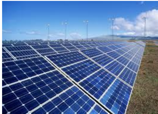
Figure 8 : Type d'installation fixe
