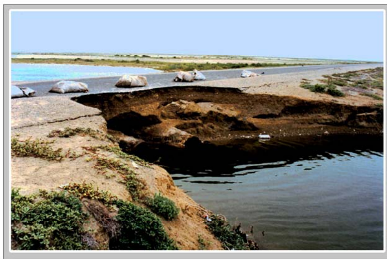
Foto 4: Sector de la Carretera Dañado Durante las Inundaciones
