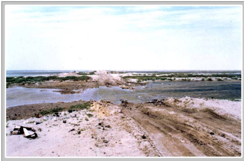
Foto 6: Carretera Destruída por las Inundaciones
